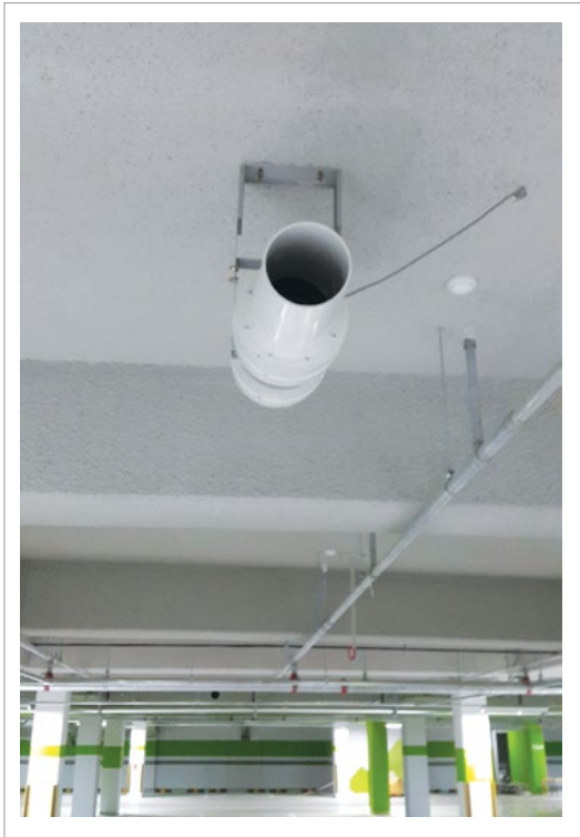
유인팬 설치 사진
